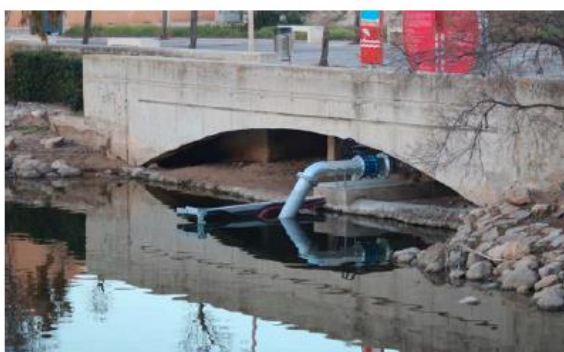
Fotografía 4 Sistema actual de bombeig permet desguassar aigua a un cabal màxim de 550 m 3 /h
